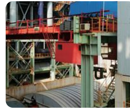
高炉冲渣水处理系统
