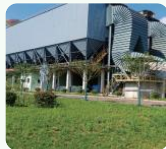
二炼钢二次除尘系统
