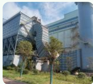
高炉矿槽布袋除尘系统
