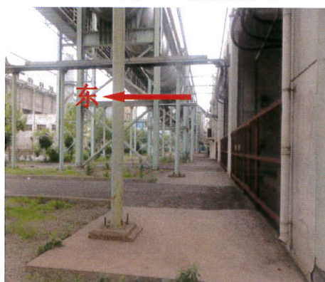
图 4-4 炼铁鼓风 110kV 变电站东侧
