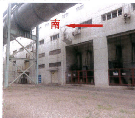
图 4-5 炼铁鼓风 110kV 变电站南侧
