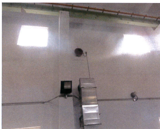
图6-6 配电室排风扇
