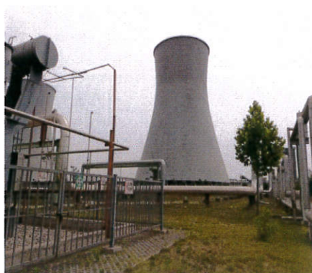
图 4-4 发电 110kV 升压站东侧
