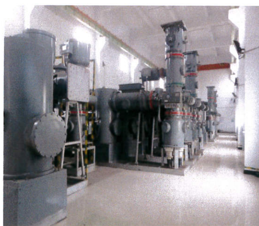
图 4-14 110kV 室内 GIS
